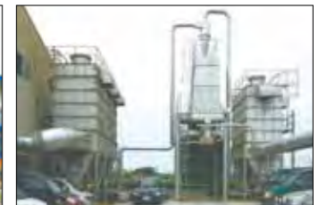
本社集塵設備
